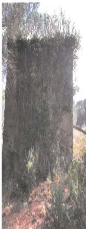
Façade Nord envahie par du lierre grimpant 4
